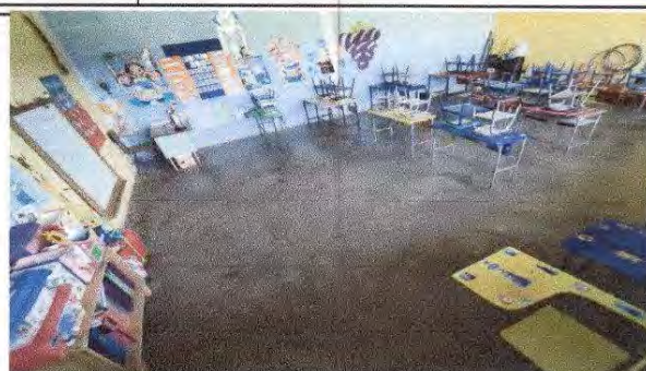
FOTO 2: Sustrucción de piso cerámico
